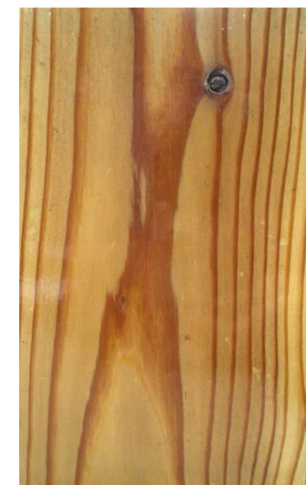
カラマツ材 屋外曝露3年間 塗膜の割れ・膨れ・剥がれ・ 白化等の劣化は見られない。
